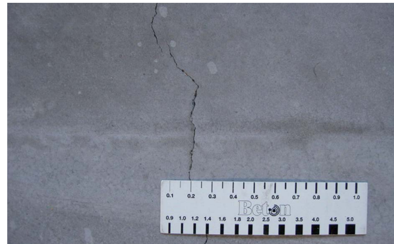
Abb. 10.3.6 Risse infolge Trocknungsschwinden
