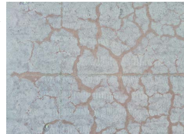
Abb. 10.7.11 (links) Rissbildung als Folge einer Alkali-Kieselsäure-Reaktion
