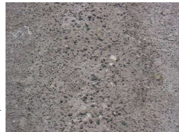
Abb. 10.5.2 Säureangriff auf Betonfläche im landwirtschaftlichen Bereich
