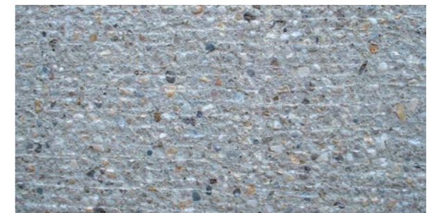
Abb. 8.3.21 (links) Abgesäuerte Oberfläche
