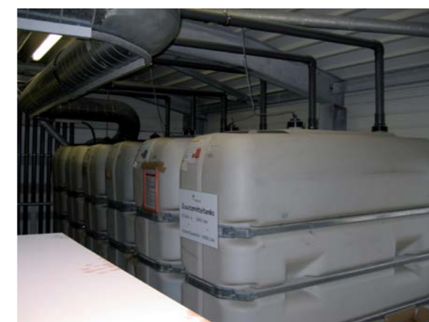
Abb. 1.5.7 Vorschriftsmäßiges Tanklager für Zusatzmittel in einem Transportbetonwerk
