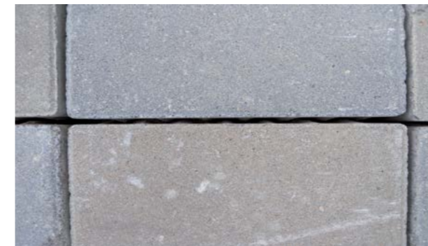
Abb. 10.2.15 Braunverfärbung durch Eisenionen des Zements
