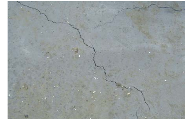
Abb. 8.5.3 Risse infolge Fröhschwinden (Austrocknung)
