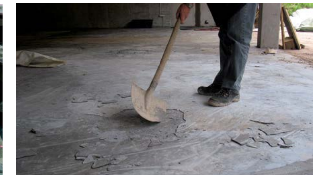
Abb. 8.4.40 Abplatzungen durch unsachgemäße Einstreuung oder falsches Glätten
