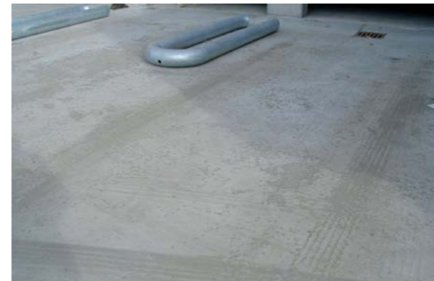
Abb. 10.4.1 Frost-Tausalz-Schaden an Beladerampen bei einem Speditionsauslieferungslager
