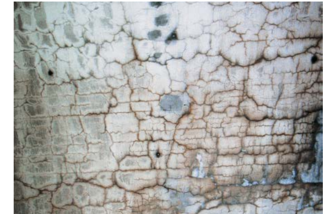
Abb. 10.7.14 Starke Rissbildung infolge Quellens des Betons, verursacht durch eine Alkali-Kieselsäure-Reaktion
