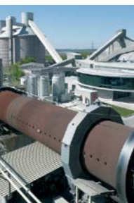
Abb. 1.1.4 Drehrohren, das Herzstück eines Zementwerks
