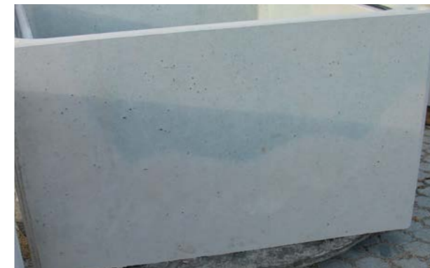
Abb. 10.2.19 Schachtbauteil mit Blaufärbung auf der geschalteten Oberfläche
