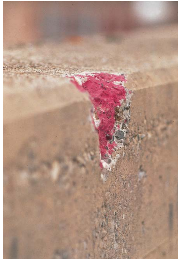
Abb. 10.8.1 Karbonatisierungsf front, die mit dem Phenolphthalein-Test auf einem Betoneinschnitt sichtbar gemacht worden ist. Wo das Phenolphthalein den Beton violett einfärbt, ist der Beton noch nicht karbonatisiert.
