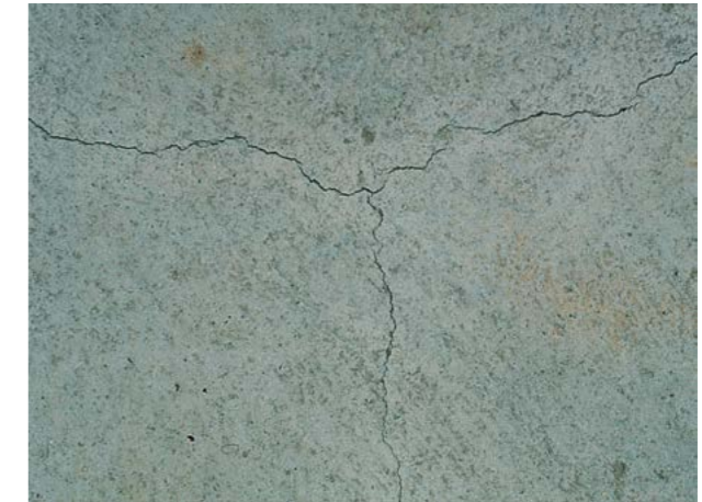
Abb. 10.3.10 Risse auf Grund von Trocknungsschwinden
