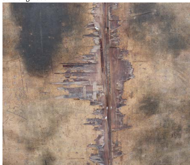
Abb. 8.3.17 (links) Beschädigte Schalungshaut
