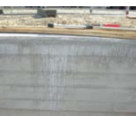
Abb. 10.2.4 bis 10.2.9 Diverse Ausblühungen an Betonoberflächen
