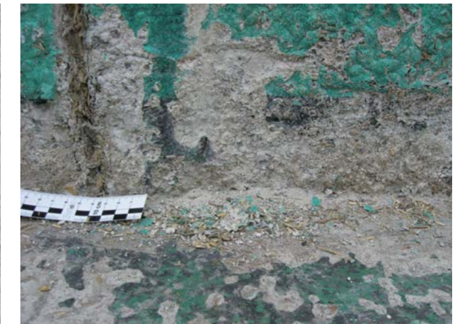
Abb. 10.5.4 (links) Lösender chemischer Angriff auf Betonoberfläche
