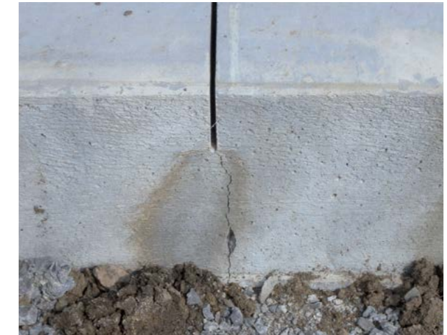
Abb. 8.4.5 Planmäßig ein- geschnittene und gerissene Fuge
