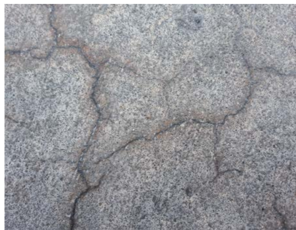
Abb. 10.7.1 Schadensbild einer Alkali-Kieselsäure-Reaktion
