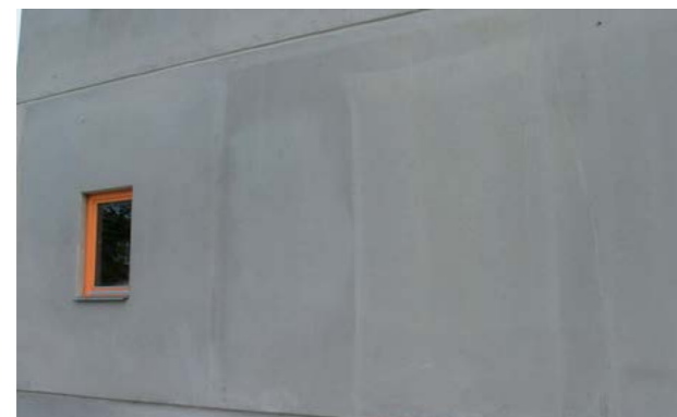
Abb. 10.2.18 Verfärbung durch das Gegeneinanderstellen unterschiedlicher Bauteile
