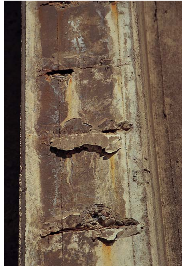
Abb. 10.8.2 Bauteil, bei dem die ungenügende Überdeckung der Bewehrung als Folge der Karbonatisierung und der Korrosion abgesprengt worden ist
